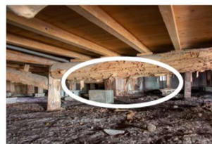
図1 シロアリの被害
