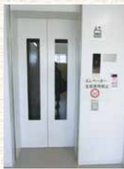
エレベーター
